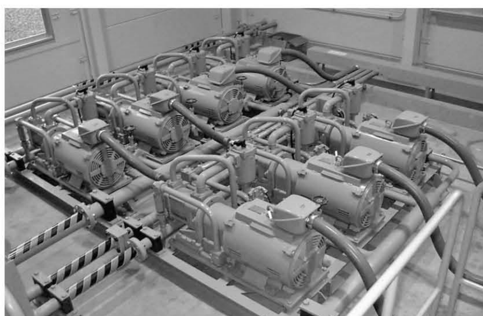
写真4 小分け油圧ポンプ装置の全景
